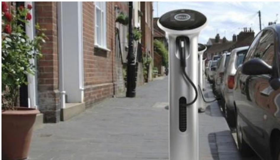
FIG. 9-15 EXEMPLU DE STAȚIE DE ÎNCĂRCARE AMPLASATĂ PE STRADĂ (SURSA: GE)
